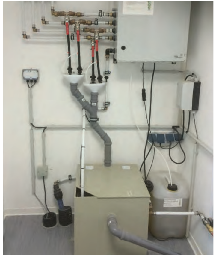
Foto: Bewässerungstechnik für eine Living-Wall (©Vertiko GmbH)
