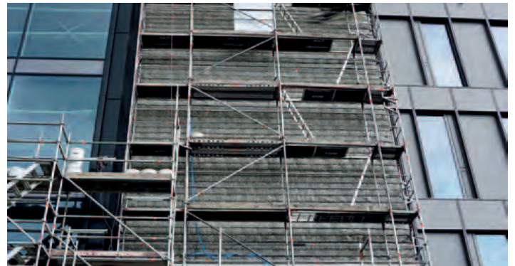
Foto: Living-Wall Fire Protect kurz vor der Bepflanzung (©Vertiko GmbH, 2021)
