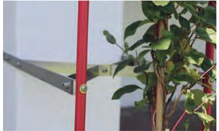
Foto: Vertikale Tragstruktur (©Thorwald Brandwein)
